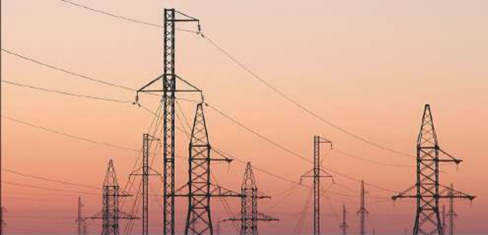
Опоры линий электропередачи
